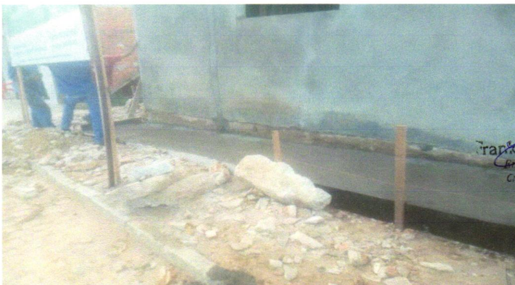
FOTO 22 – EXECUÇÃO DE PASSEIO (CALÇADA) OU PISO DE CONCRETO COM CONCRETO MOLDADO IN LOCO, FEITO EM OBRA, ACABAMENTO CONVENCIONAL, ESPESSURA 8 CM, ARMADO. AF_07/2016
