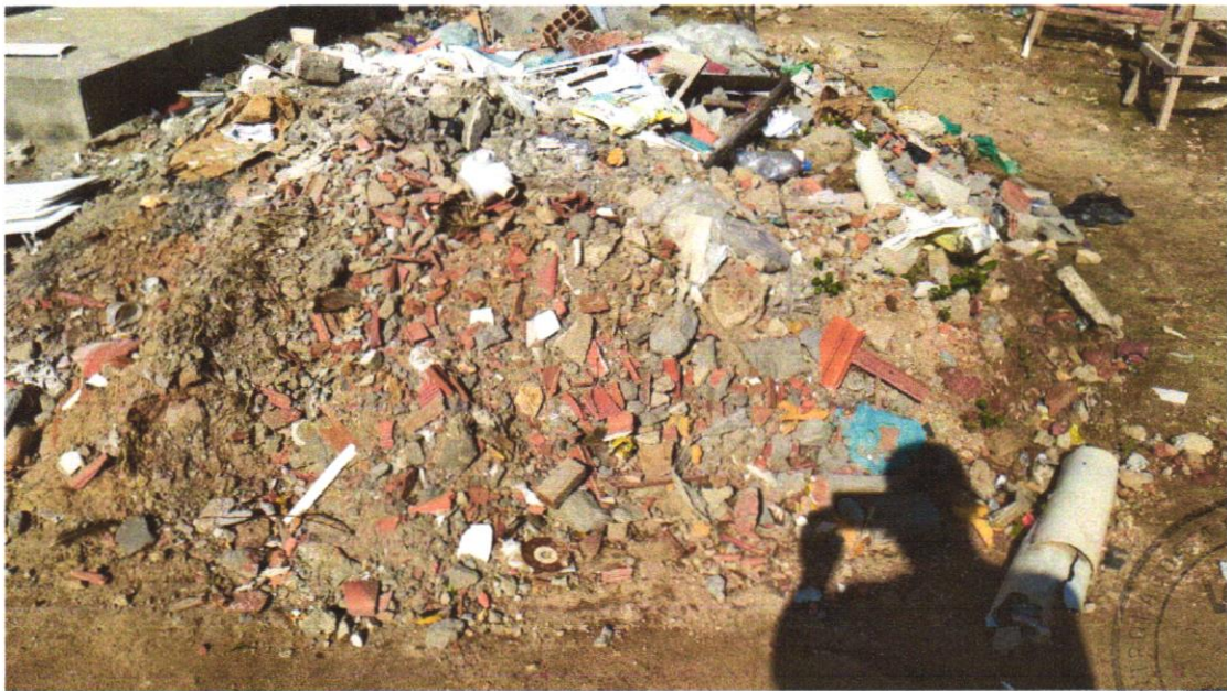
Foto 30 - DEMOLIÇÃO DE ALVENARIA DE BLOCO FURADO, DE FORMA MANUAL, SEM REAPROVEITAMENTO. AF_12/2017
