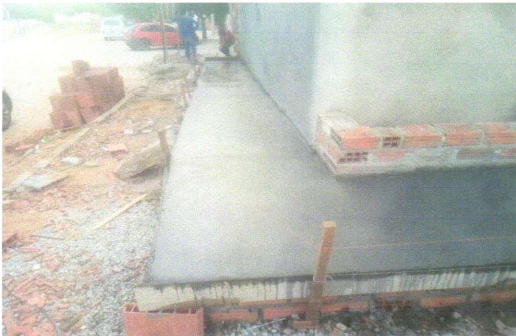
FOTO 21 – EXECUÇÃO DE PASSEIO (CALÇADA) OU PISO DE CONCRETO COM CONCRETO MOLDADO IN LOCO, FEITO EM OBRA, ACABAMENTO CONVENCIONAL, ESPESSURA 8 CM, ARMADO. AF_07/2016
