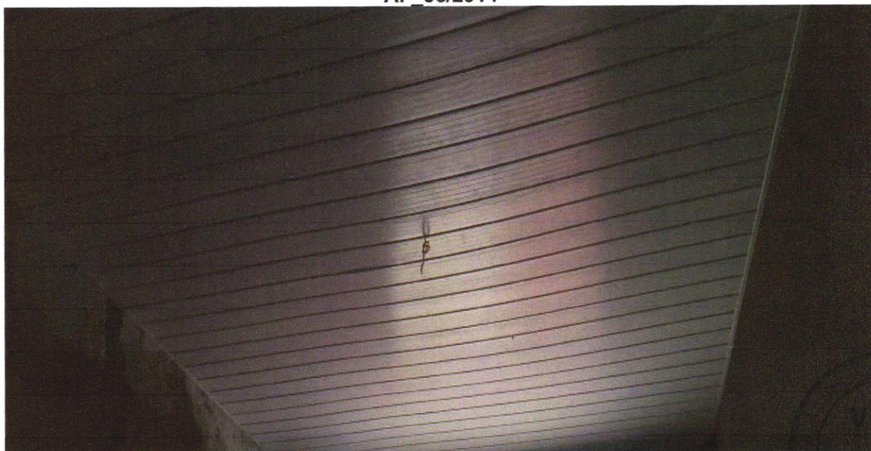
FOTO 12 - Forro de pvc, em régua de 10 ou 20 cm, aplicado, inclusive estrutura para fixação (perfis em PVC) marca Araforros ou similar, instalado - Rev 06_10/202
