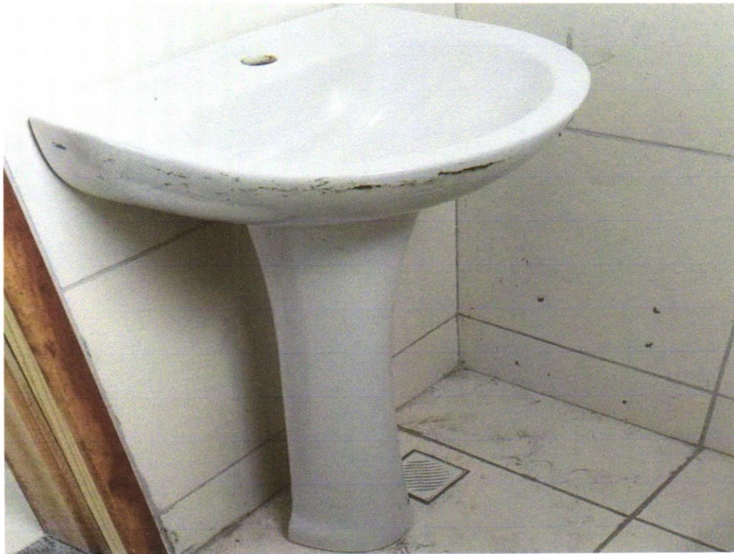
FOTO 03 - LAVATÓRIO LOUÇA BRANCA COM COLUNA, 45 X 55CM OU EQUIVALENTE, PADRÃO MÉDIO - FORNECIMENTO E INSTALAÇÃO. AF_01/2020
