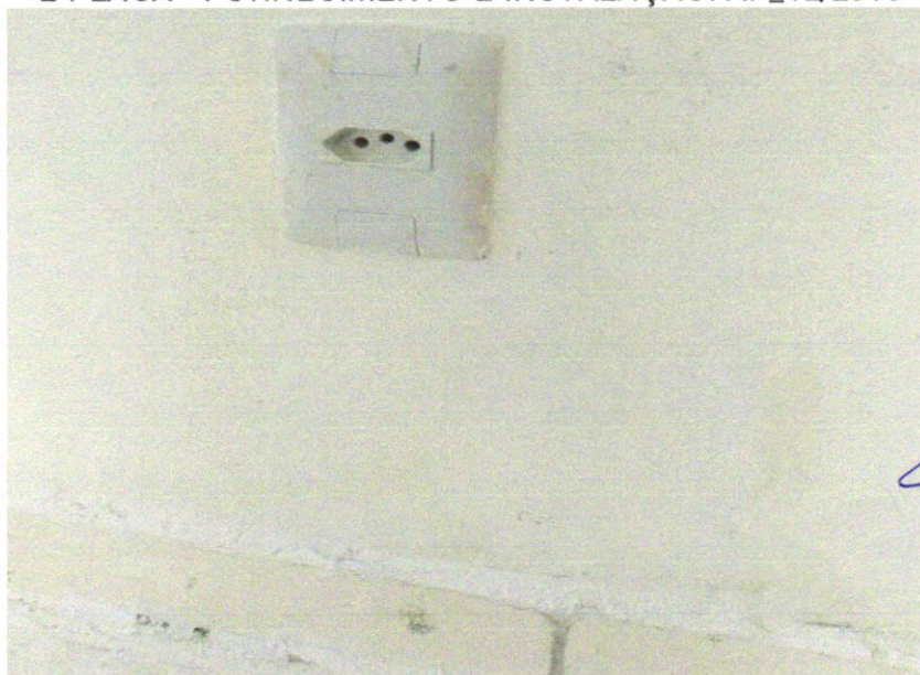
Foto 34 – TOMADA BAIXA DE EMBUTIR (1 MÓDULO), 2P+T 10 A, INCLUINDO SUPORTE E PLACA - FORNECIMENTO E INSTALAÇÃO. AF_12/2015
